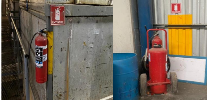
Figura 39. Extintor manual y sobre ruedas actual
