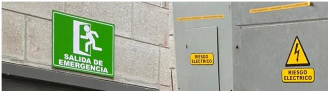
Figura 40. Señalización en áreas de trabajo
