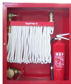
Figura 4. Hidrante de gabinete
