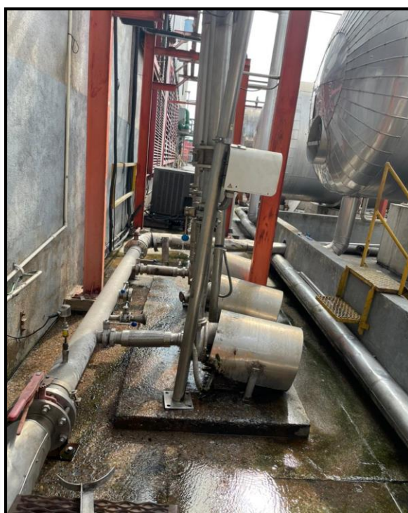
Fotografía 8: Identificación de pérdida de agua: Fuga en área de fabricación
