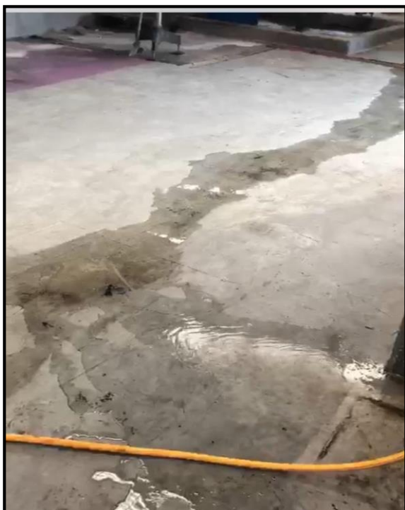
Fotografía 7: Identificación de pérdida de agua: Fuga en área de packaging
