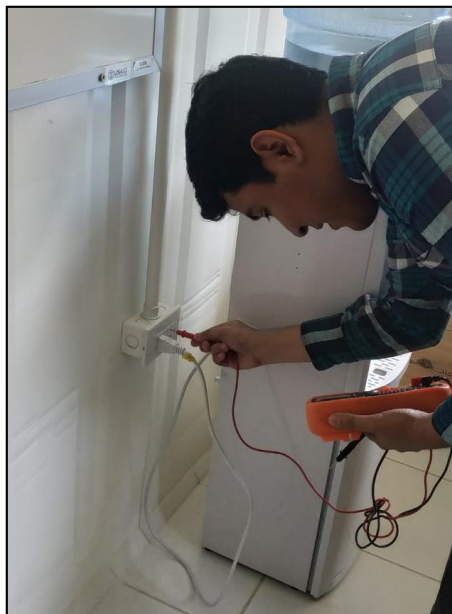
Fotografía 6. Medición de voltaje con multímetro.
