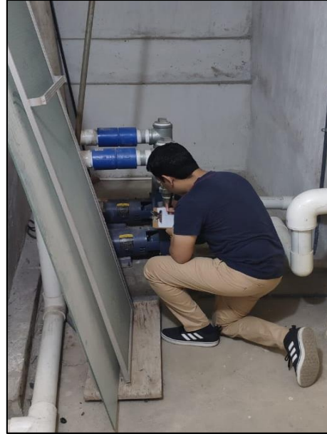
Fotografía 10. Medición de intensidad con pinza amperimétrica en equipos de bombeo.
