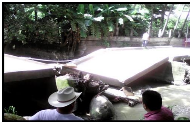
Vecinos de Barrio Pueblo Nuevo observando el puente del río Chapulapa dañado en 2015, por las fuertes tormentas.
