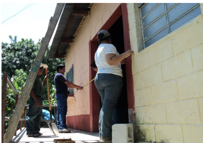
Foto A11. Sistema de captación para ingreso en panadería
