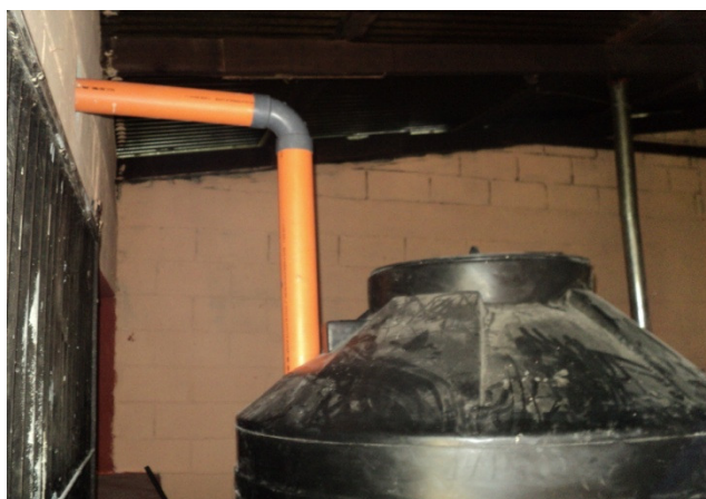
Foto A12. Sistema de captación conectado en tinaco
