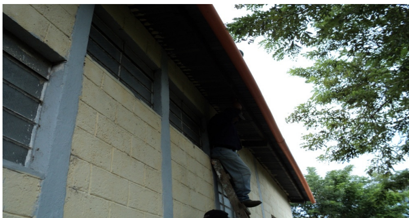
Foto A10. Sistema de captación de agua pluvial
