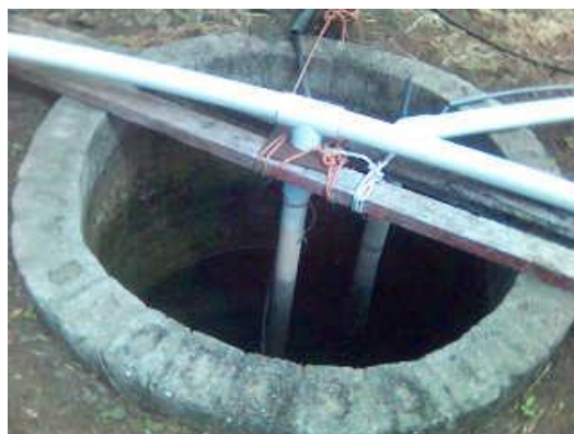
Pozo de 10 m. de profundidad con bomba de 10 caballos de fuerza
