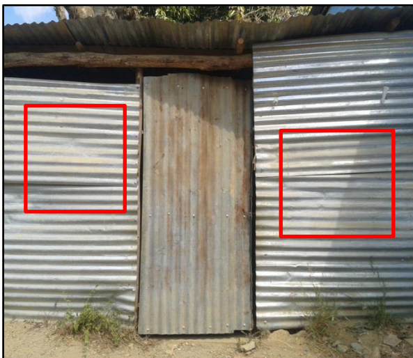
Fotografía 24 Daño observable en Paredes/Muros: Corrosión EODP caserío El Nanzal, aldea El Palmar. Zona homogénea 2 Chiquimula, 2016.
