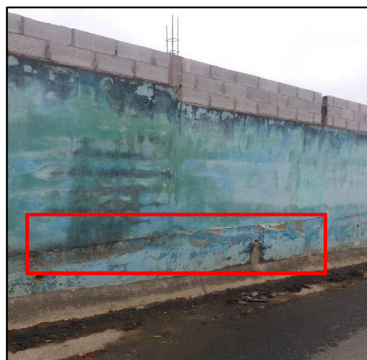
Fotografía 27 Daño observable en Paredes/Muros: Grietas EODP "Manuel Vicente Castañeda" Aldea El Pinalito. Zona homogénea 4 Chiquimula, 2016.
