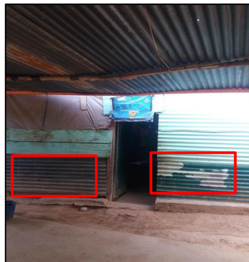
Fotografía 25 Daño observable en Paredes/Muros: Corrosión EORM caserío Guayabillas, aldea El Palmar. Zona homogénea 2 Chiquimula, 2016.
