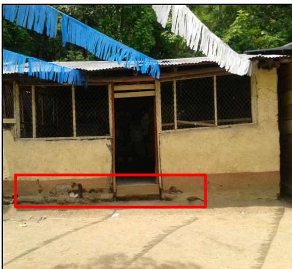
Fotografía 26 Daño observable en Paredes/Muros: Grietas EORM caserío El Chucte, aldea Guior. Zona homogénea 1 Chiquimula, 2016.
