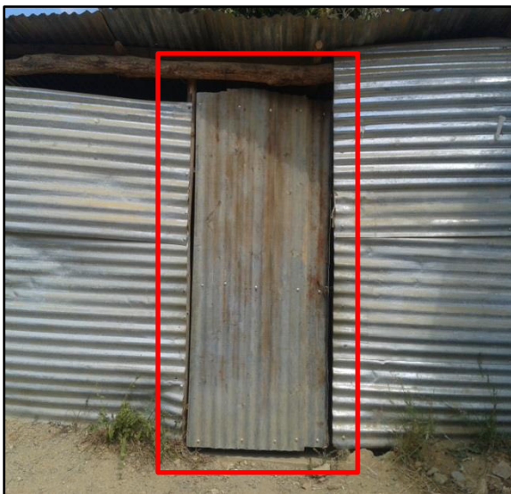
Fotografía 40 Daño observable en Puertas: Corrosión EODP caserío El Nanzal, aldea El Palmar. Zona homogénea 2 Chiquimula, 2016.
