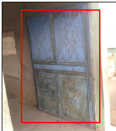
Fotografía 41 Daño observable en Puertas: Corrosión EORM aldea Plan del Guineo. Zona homogénea 1 Chiquimula, 2016.
