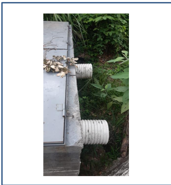
Desfogue planta de tratamiento por rebalse
