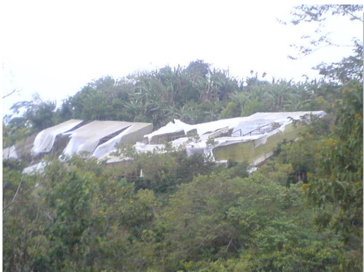
Figura 6. Invernadero tipo parral, con daños en el techo por acción de fuertes vientos. Propietario Luis Alfredo Núño, Jocotán, Chiquimula.
