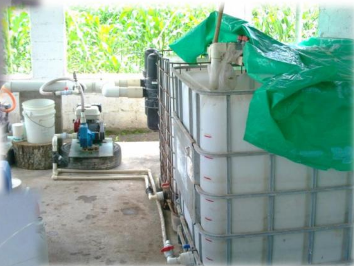
Estación de riego
