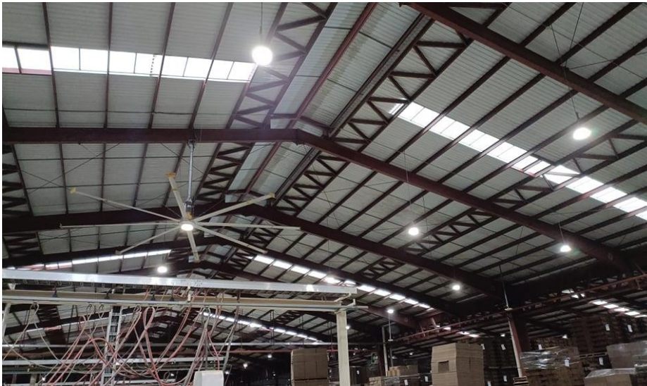
Figura 29. Sistema de ventilación actual del área de conversión
