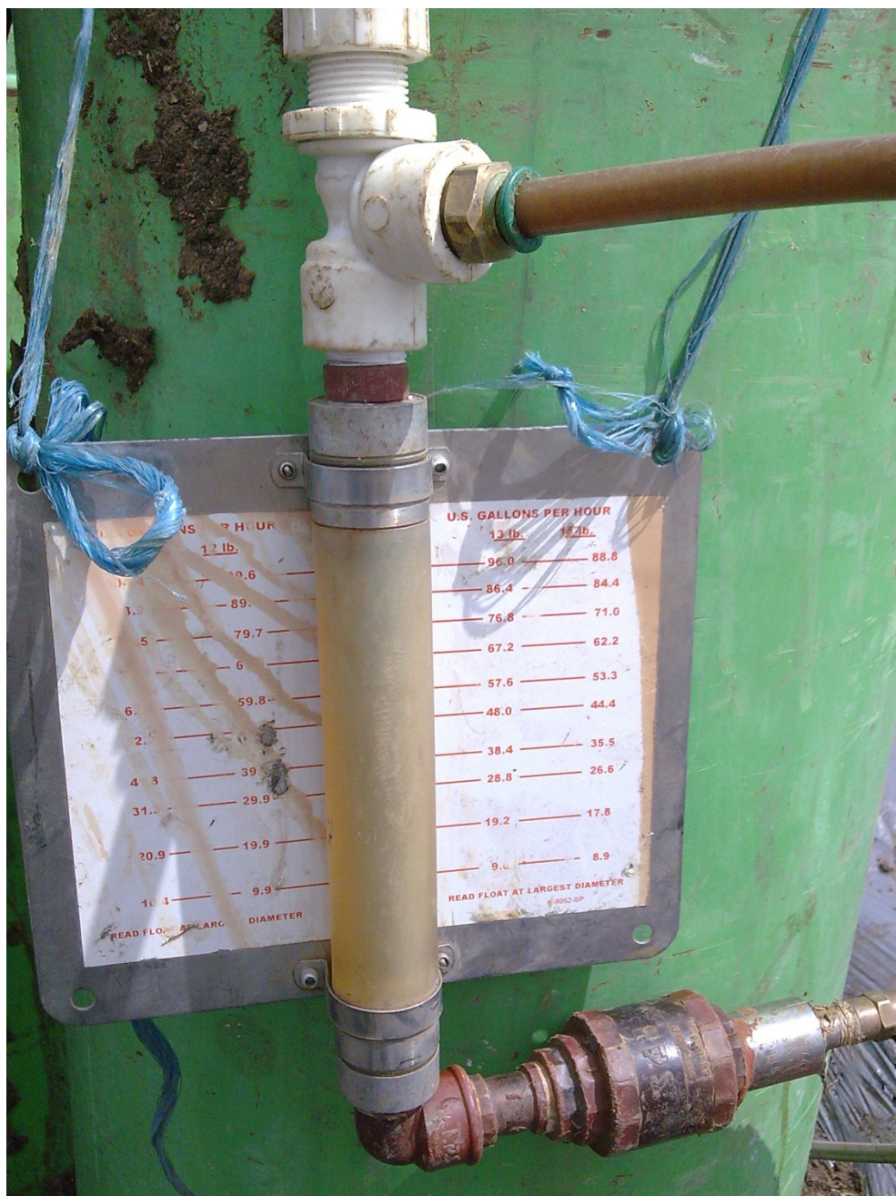
Figura 23. Flujómetro utilizado para dosificar de una forma adecuada el producto.
