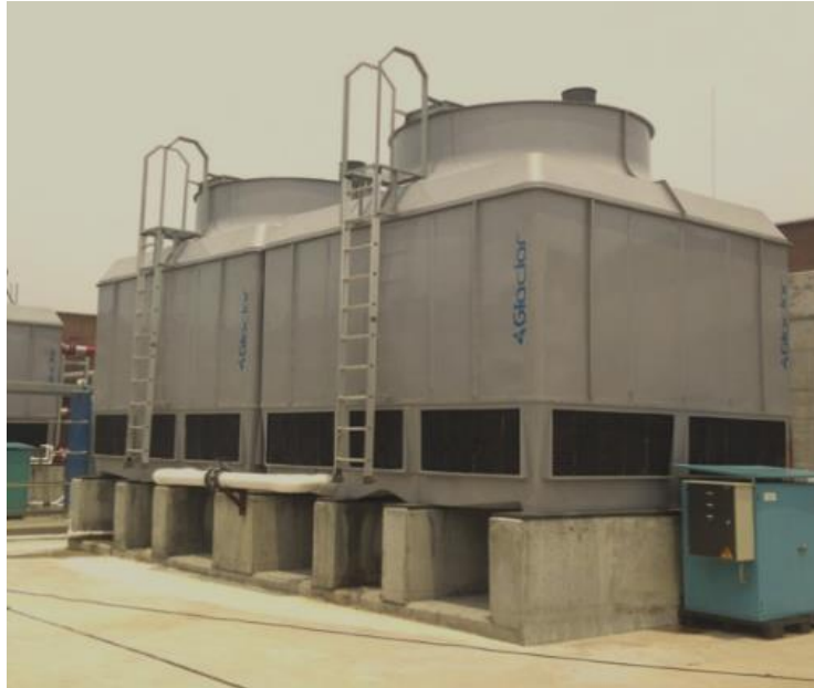
Figura 6. Torres de enfriamiento
