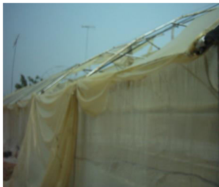
2. Daños en la cubierta de techo de invernadero
