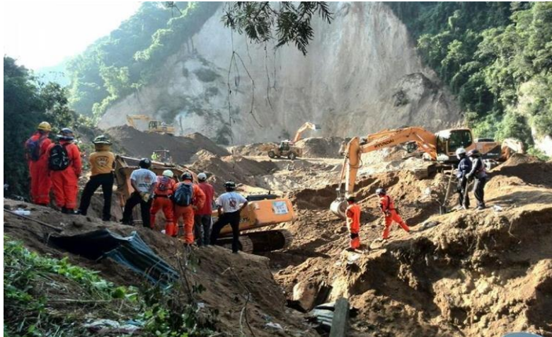
Imagen del deslizamiento de Cambray 2, declarado Estado de Calamidad, que se muestra en etapa de recuperación.
