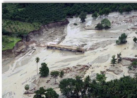
Imagen 1. Puente El Rico, colapsado por la fuerte corriente provocada para la Tormenta Tropical Agatha
