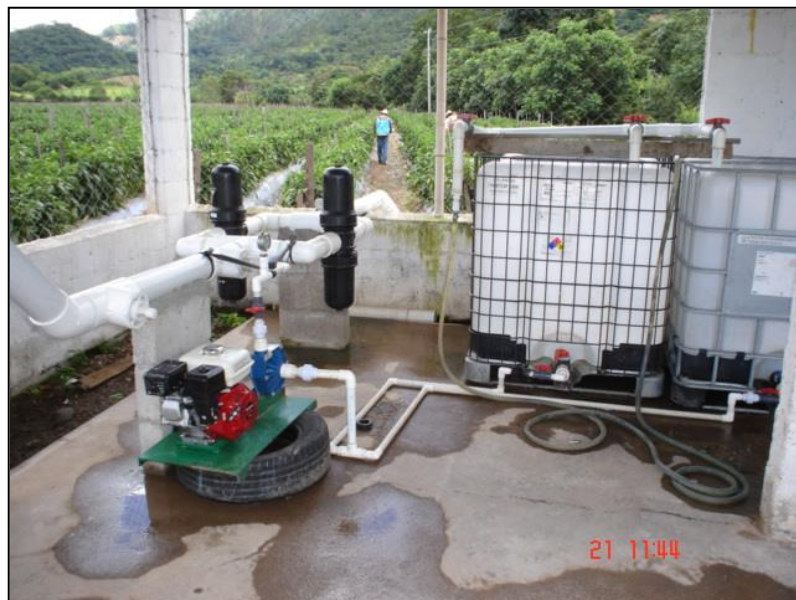
Fig. 2 Sistema de riego con bomba de inyección
