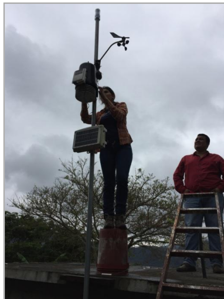
Figura 4: Mantenimiento preventivo a estación meteorológica ubicada en Tuticopote, Olopa.
