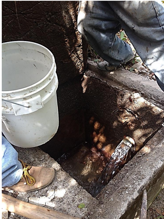
Anexo 1. Caja de distribución, fuente Los Planes
