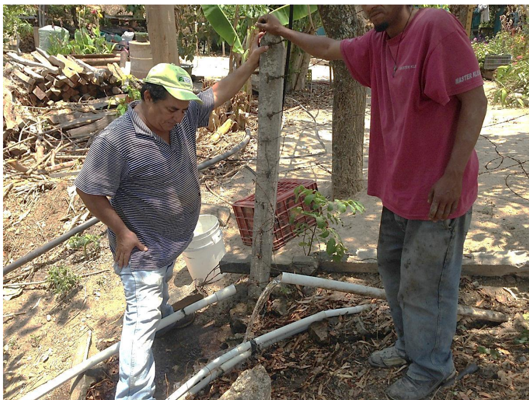
Anexo 4. Tubería que recoge el agua de la fuente Compostela Quebrada
