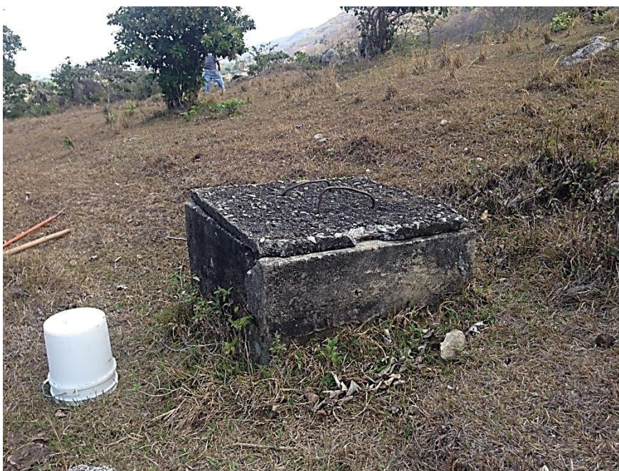
Anexo 5. Caja de distribución, fuente Cayaguanca
